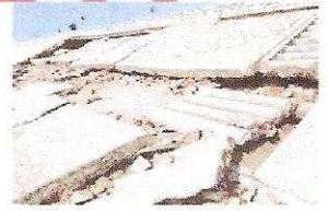
Sous les coups de boutoir des vagues, le perré a fini par céder au niveau du lieu-dit Pleine Mer à Damgan.
